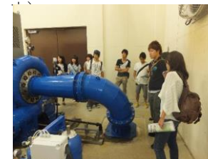
北杜市村山六ヶ村堰水力発電所(山梨県北杜市)
